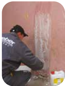
Premazivanje zaraženog mjesto Weber odstranjivačem algi
